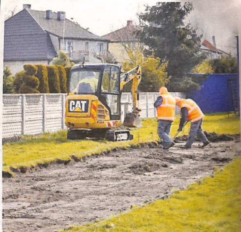
Na zdjęciu rozpoczęcie prac przy montażu nowych fotelików na widowni odolanowskiego stadionu.
